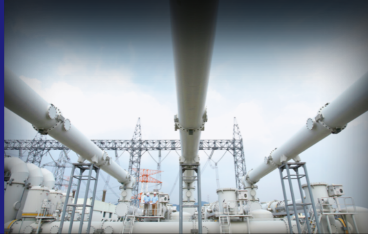
세계최초 800kV GIS 개발
